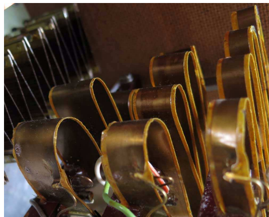
Bändershunts im AC Transfermeter Hermach-Engelhard C
